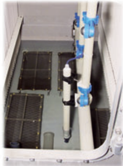
Blick in den Luftwäscher auf den tauchfähigen LF-Sensor und die Reaktionsmatten
